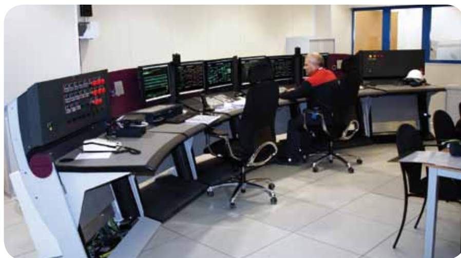
Sala de control
